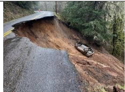
landslide / зсув ґрунту
