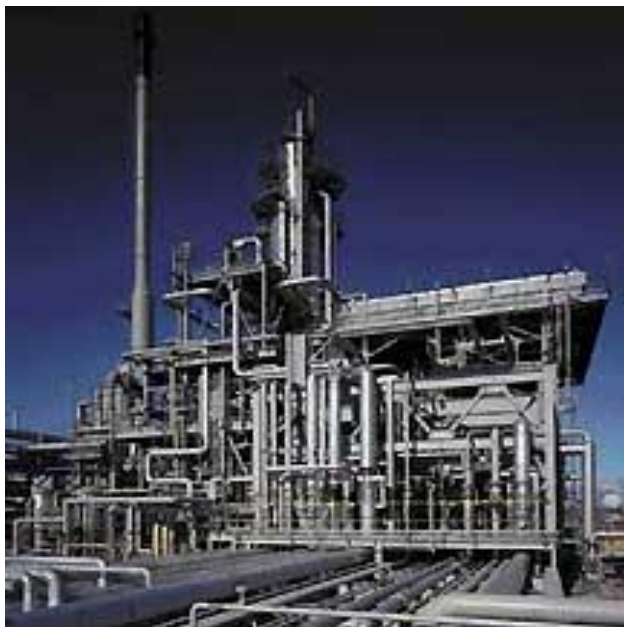
Рисунок 2.8. – Установа гідроочистки дизельного палива: зліва видно пічну трубу; посередині – відгонну колону
