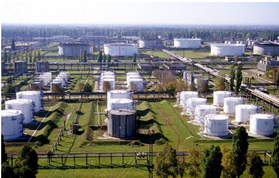
Рисунок 2.1 – Нафтопереробний завод. Резервуарний парк
