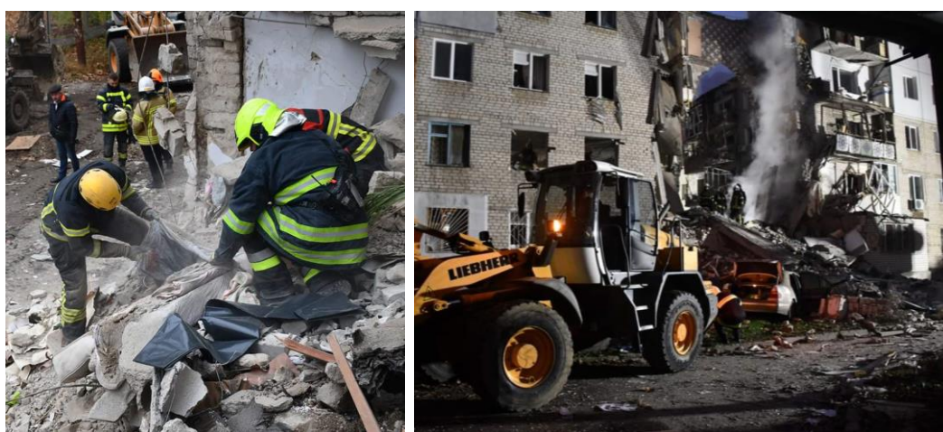
Рис. 3. Проведення пошукових та АРР на зруйнованих будівлях
