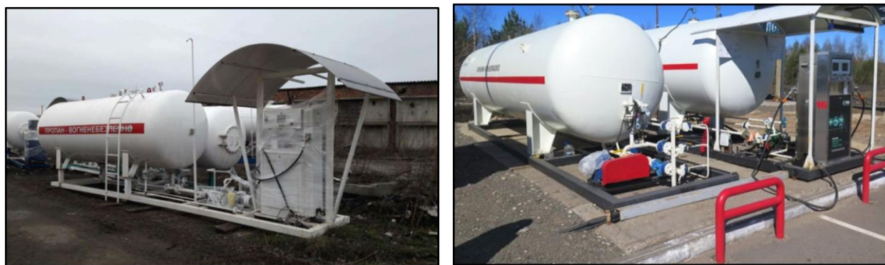
Рис. 22.4 – АГЗС з двома надземними резервуарами
