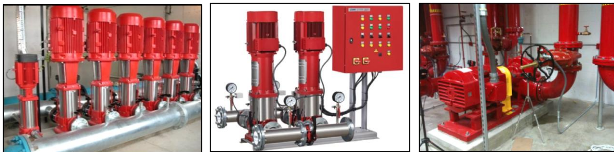
Рис. 7.8 – Приміщення станцій пожежогасіння з насосним обладнанням
