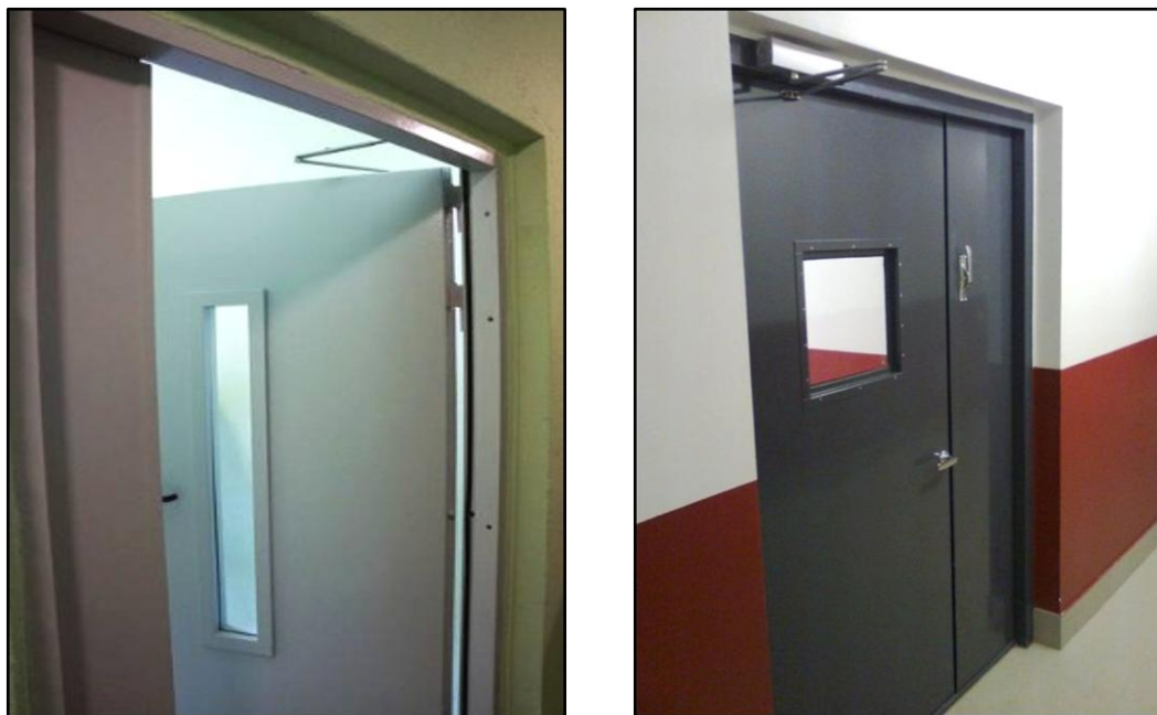
Рис. 11.13 – Двері сходових кліток з ущільненням в притворах та з пристроями для самозачинення
