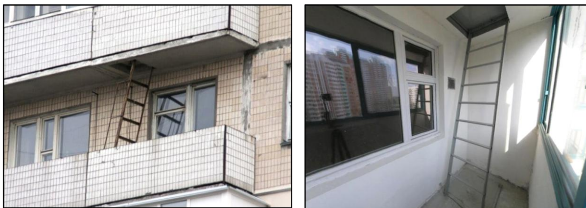
Рис. 14.3 – Вихід з балконів (лоджій) квартир або безпосередньо з квартир через двері на зовнішні металеві маршові сходи
