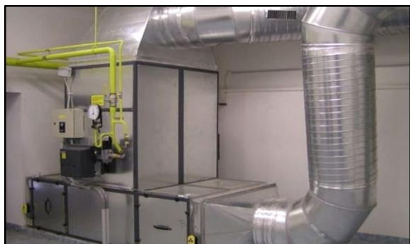
Рис. 21.1 – Зовнішній вигляд установки повітряного опалення
