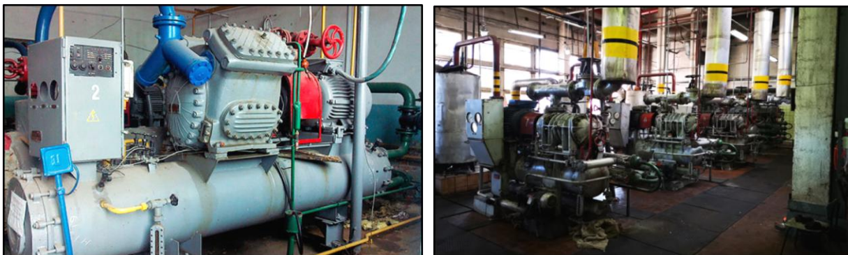
Рис. 21.13 – Компресори холодильних установок з холодоагентом
