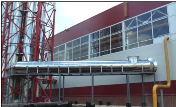
Рис. 22 –6. Легкоскидні огороджувальні конструкції котельні у вигляді вікон
