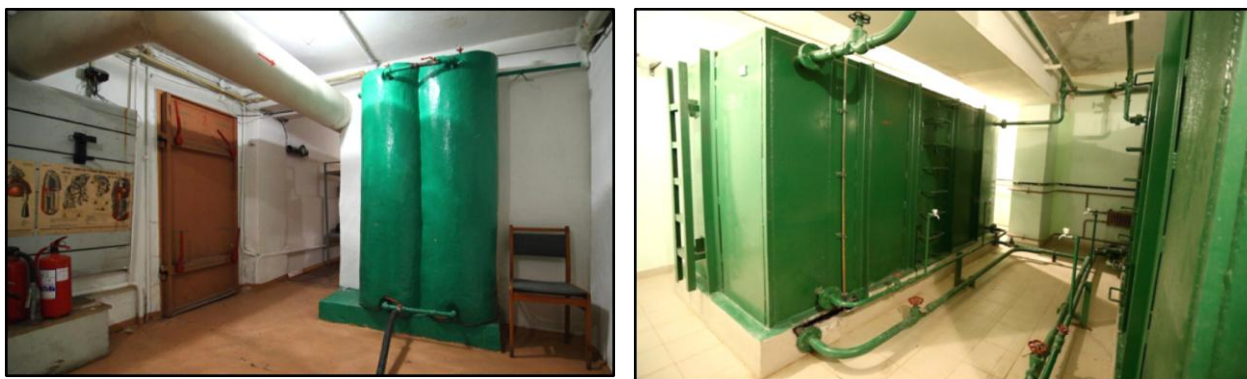
Рис. 20.8 – Баки з технічною водою
