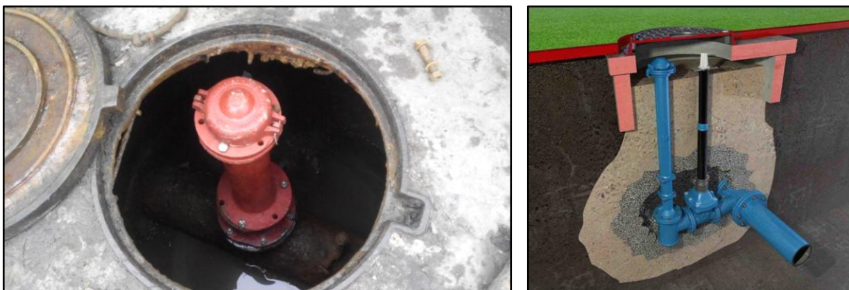
Рис. 7.2 – Пожежні гідранти з колодязями встановлених на водопровідній мережі
