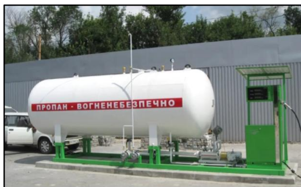
Рис. 22.2 – Автомобільний газозаправний пункт
