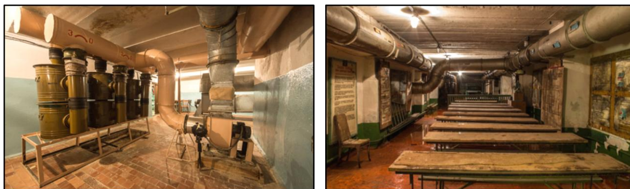
Рис. 20.6 – Вигляд системи вентиляції захисних споруд цивільного захисту
