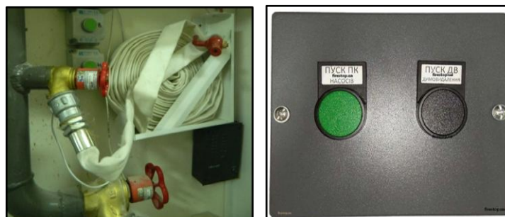
Рис. 11.2 – Пожежний кран-комплект з кнопками дистанційного відкриття поповерхових клапанів димовидалення, підпору повітря, запуску пожежних насосів
