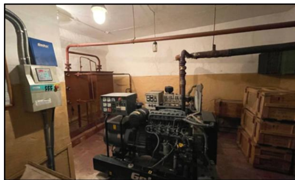
Рис. 20.2 – Вигляд захищеної дизельної електростанції
