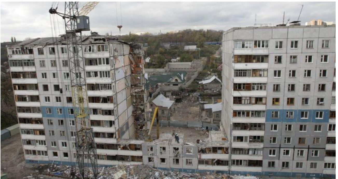
Рис. 3. Ефект прогресуючого руйнування панельного будинку в результаті вибуху газу
