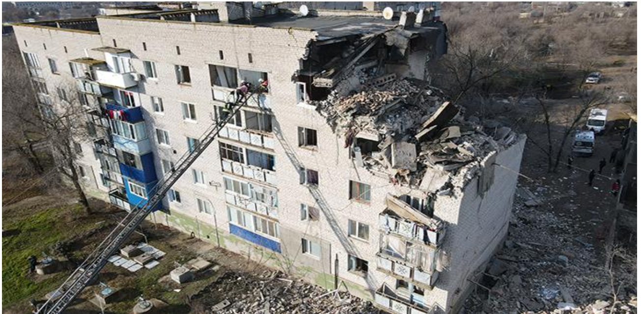
Рис. 4. Руйнування будинку внаслідок вибуху газу
