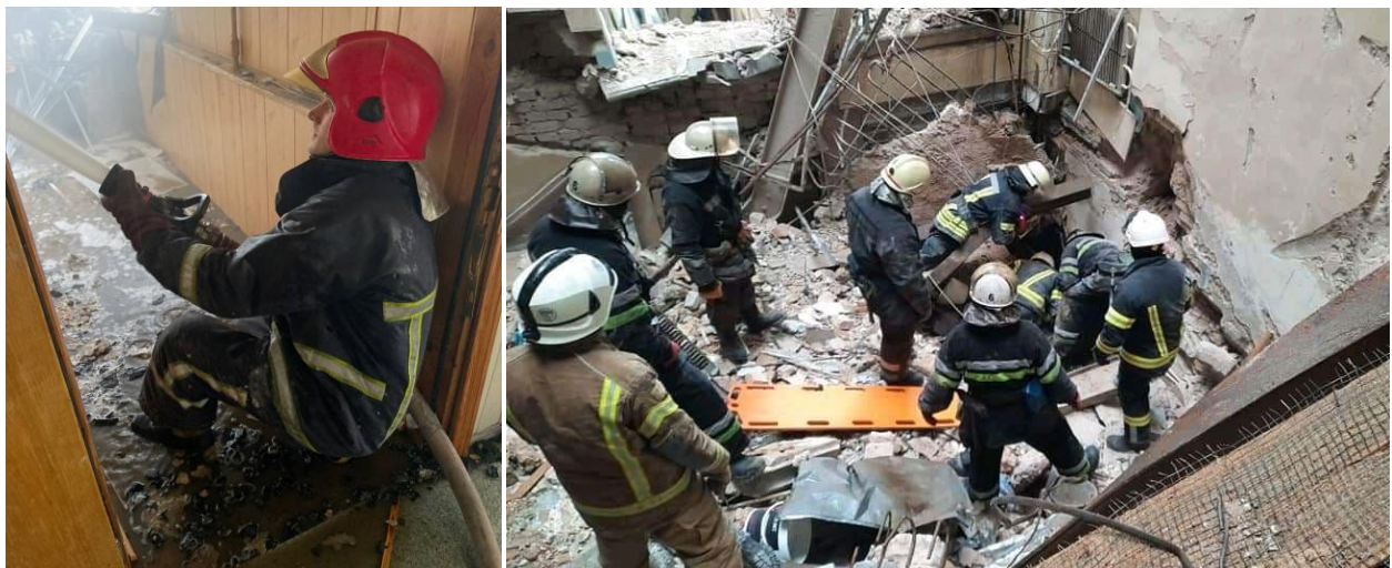
Рис. 8 – Гасіння пожежі по вул. Мироносицькій (зліва), розбирання завалу по вул. Жон Мироносиць (справа)
