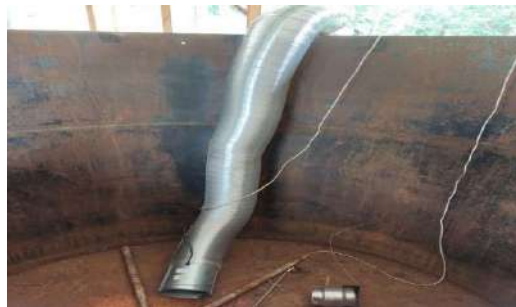
Рис. 3. Витяжна труба з вентилятором.
