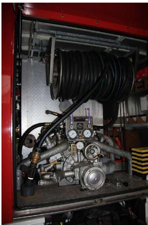
Рис. 1. Вигляд насосної установки та спеціального обладнання для подавання тонкорозпиленого струменя води на гасіння пожежі.
