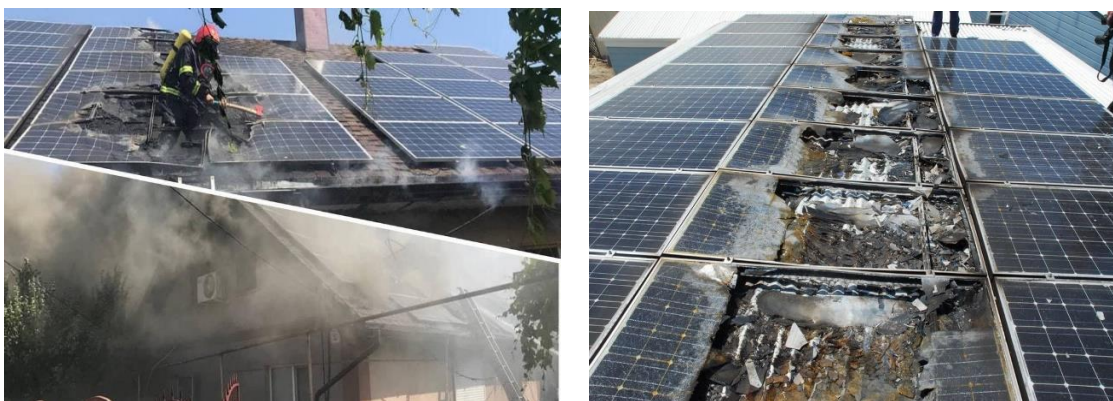
Рисунок 1 – Пожежі фотоелектричних модулів на дахах будинків
